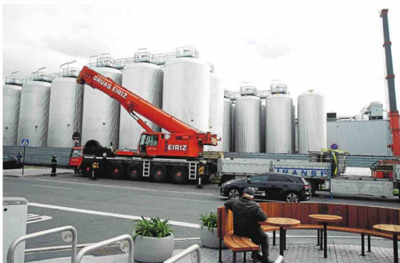
Un hombre observa las tareas de colocación de los dos nuevos depósitos en la fábrica de Hijos de Rivera | PATRICIA G. FRAGA
